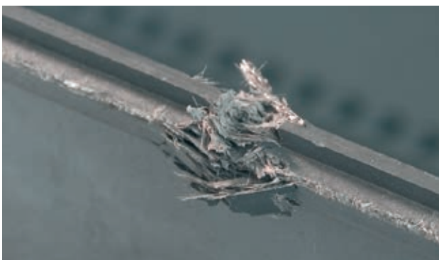
Bild 12: Beispiel für Beschädigungen der Dichtlippe von Gehäusen
