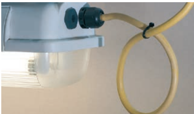
Bild 5: Kabelschleife schützt vor Eindringen des Wassers
