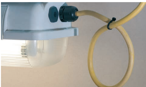
Bild 5: Kabelschleife schützt vor Eindringen des Wassers
