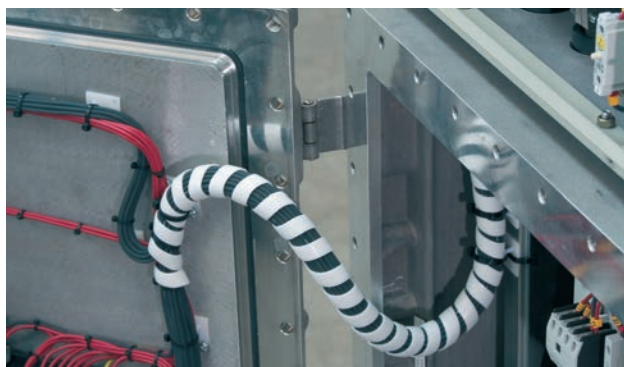
Bild 2: Kabel und Leiter sind vor mechanischer Beschädigung geschützt
