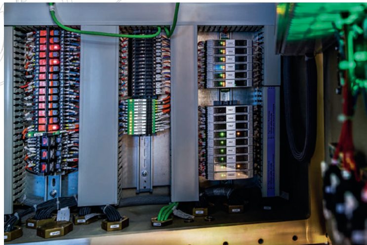
Kundenspezifisch entwickelte Lösung zur Anlagensteuerung in explosionsgeschützter Ausführung mit Schlüsselkomponenten von R. STAHL
